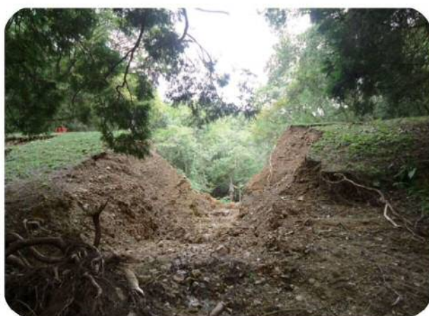
平成25年9月、台風18号による大雨により決壊したため池
