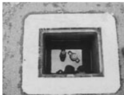
⑤ 消火栓の中はこのようになっています。
