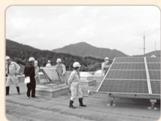
★役場庁舎太陽光発電設備(完成)
