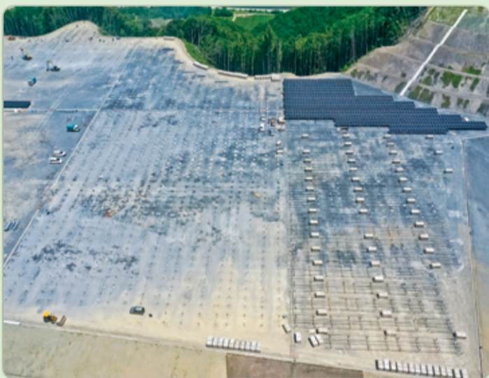
発電用パネルの設置状況
